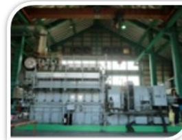
【ディーゼル発電施設】(穴澗) 1999 年に日本政府の人道支援により供与した発電所。ディーゼル発電機 860kw×3 基。
